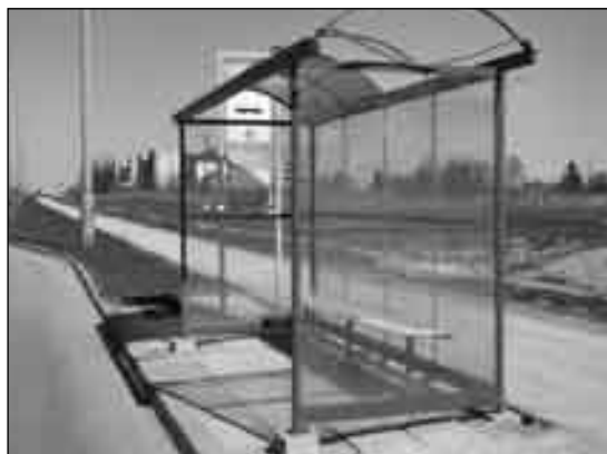
Zdewastowany przystanek przy ul. Armii Krajowej
