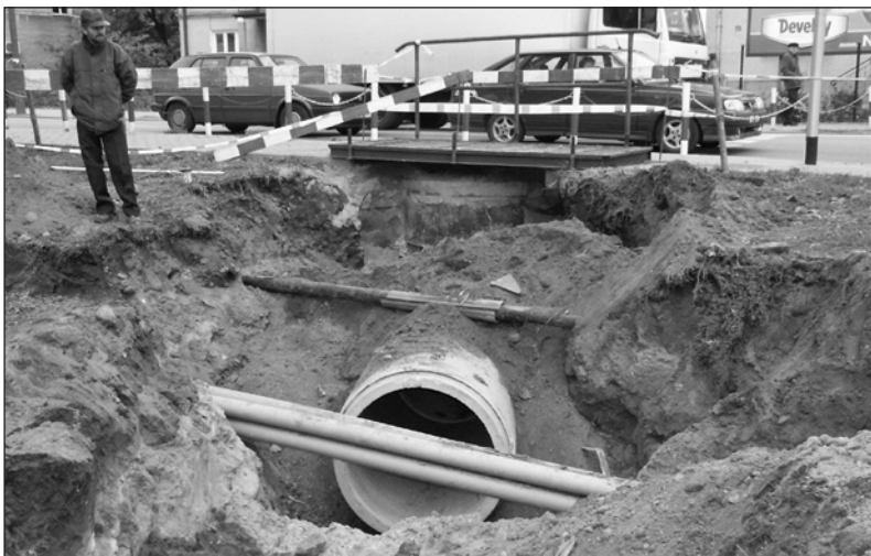
Kolektor deszczowy wybudowany na ul. Sienkiewicza blisko dwa lata temu
