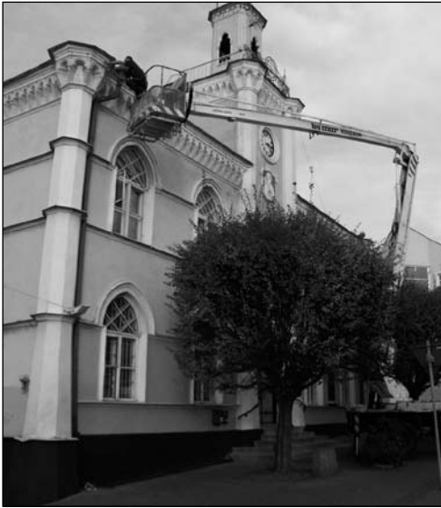
Od lat nie remontowany ratusz wymagał wielu bieżących napraw
