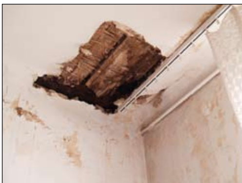
W ratuszu tynk odpada ze ścian i sufitów
