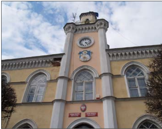
Sypiąca się elewacja ratusza już niedługo doczeka się remontu
