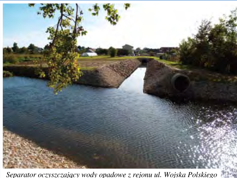
Separator oczyszczający wody opadowe z rejonu ul. Wojska Polskiego
