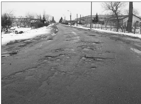
Tak wyglądają drogi przejęte od starostwa. Tu ulica Śmiecińska
