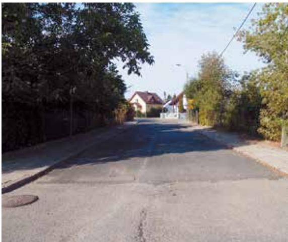
ul. Bema przed remontem
